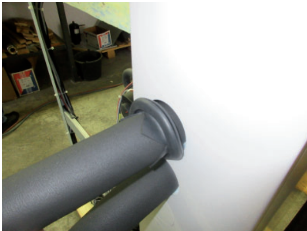
Anschlusschläuche mit fertig montierter Isolierung
