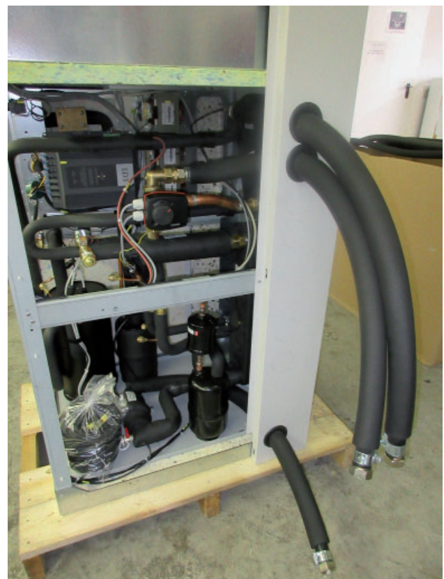
Fertig montierte Anschlusschläuche bei der AERO SLM 3-11
