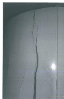
Abb.: Risse in der Isolierung, entstanden durch die Anwendung von lösungsmittelhaltigen Reinigern.
