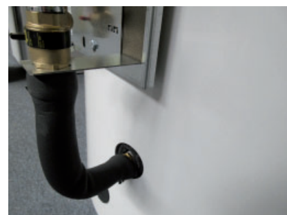
Anschluss unten mit Armaflex-Isolierung
