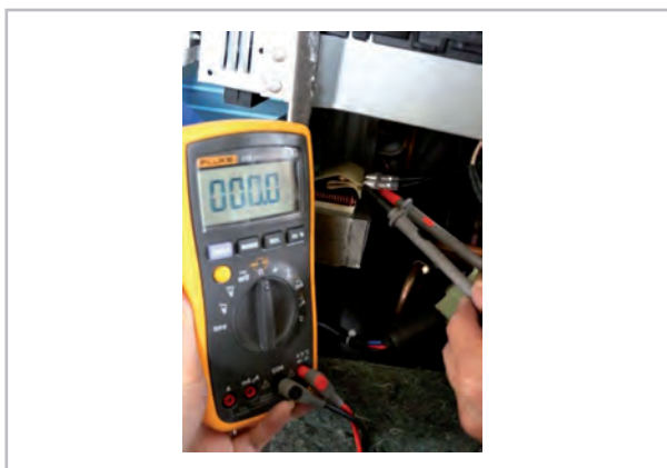
Abb. 42: Messung des Transformators
